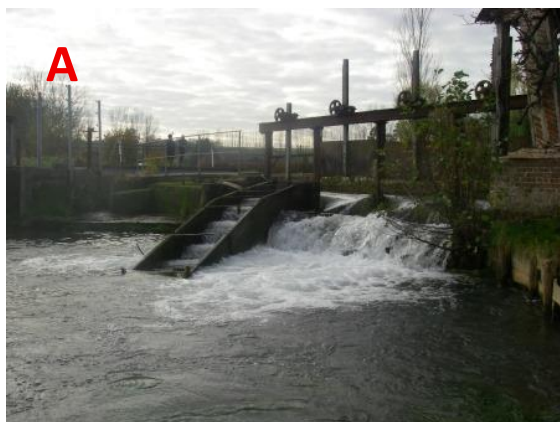
Figure 9 : Seuil de la Pisciculture de Grainville-la-Teinturière (BDOE)
